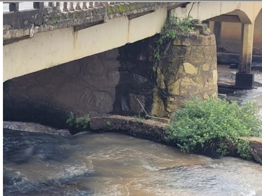
Figura 07: Detalhes de vegetação crescendo junto a base da ponte.
