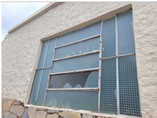
Figura 07: Detalhes de vidro quebrado de um dos basculantes. Autoria: Dalva Cristina de Sousa. Data: 20/11/2023.
