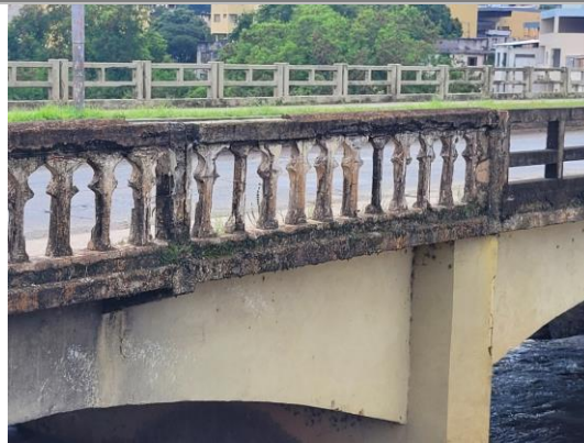
Figura 08: Detalhes do guarda-corpo escurecido e com crescimento de limo.
