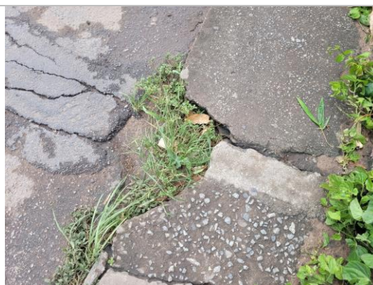
Figura 16: Detalhes de trechos do passeio com perdas e trincas.
