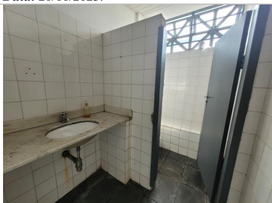
Foto 09: Vista de um dos banheiros no pavimento térreo. Autoria: Dalva Cristina de Sousa. Data: 20/11/2023.
