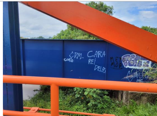
Figura 12: Detalhes da estrutura ativa com pichações. Autoria: Dalva Cristina de Sousa.
