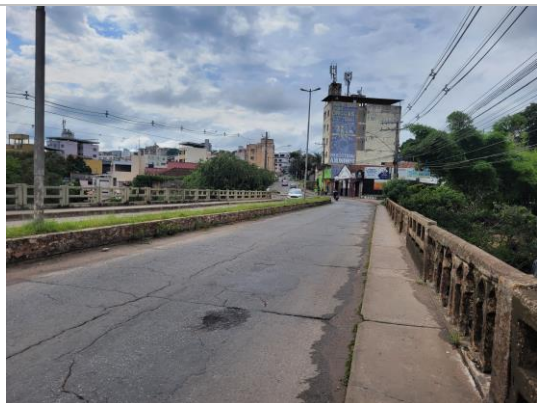
Figura 13: Vista geral da pavimentação asfáltica com fissuras.
