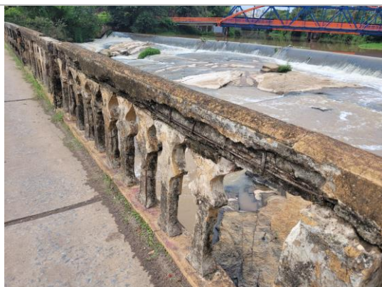
Foto 09: Detalhes do guarda-corpo apresentando perdas e corrosões das ferragens.
