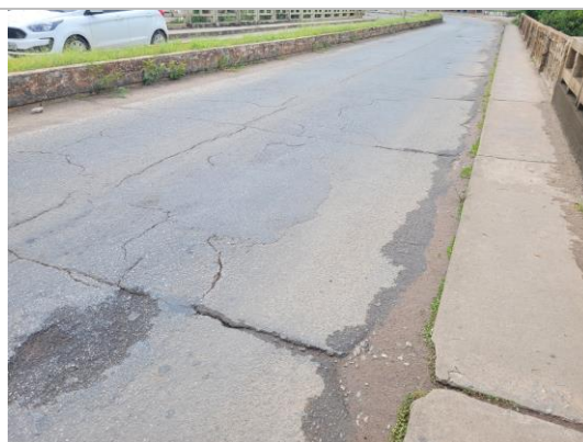
Figura 12: Detalhes da pavimentação do tabuleiro apresentando fissuras e perdas.
